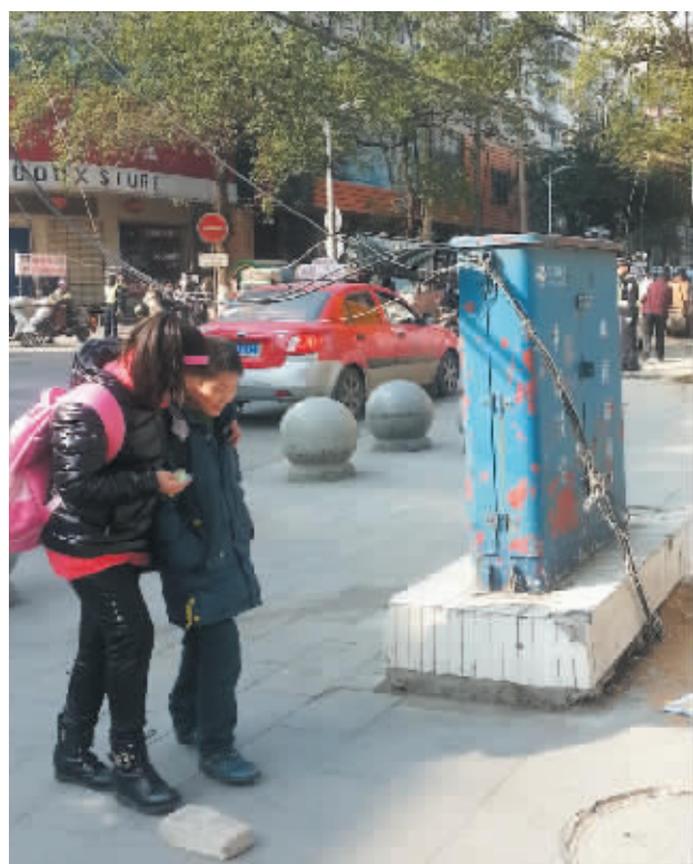
昨日上午,记者在市区礼节路看到,一电线因年久失修垂落下来,此处毗邻学校,上下学期间,经常有学生通过,垂落下来的电线紧挨学生身体,非常危险,希望有关部门能早日维修。本报记者 王洋 摄
