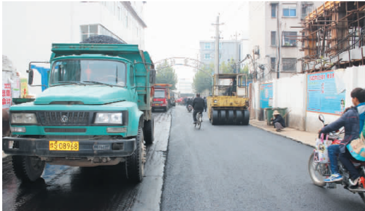
由于近年建筑工程车辆往来频繁,导致市区南湖路至信阳师院东门的徐堂大道损毁严重,沿线居民出行受阻。近日,作为辖区单位的浙河区金牛山办事处,出资100余万元对徐堂大道铺设柏油路面,并规划停车线,确保道路畅通。图为施工时的场景。 本报记者 张勇 摄
