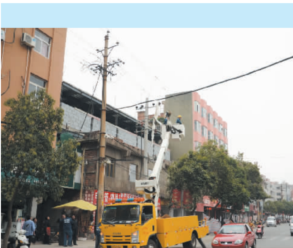
10月16日上午,记者经过人民路时看见一处电缆上挂着很多白色塑料袋。据了解,这些白色塑料袋是从附近一个正在施工的建筑工地飘出来的。为避免发生意外情况,电力部门工作人员对挂在电线上的塑料垃圾进行清除。见习记者 韩蕾 实习生 买祥发 摄
