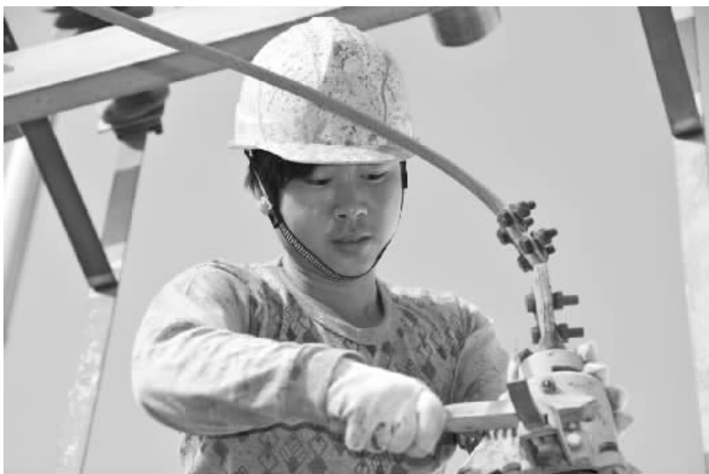
日前,固始县电业局对武昌35千伏变电站的室外设备及构架进行全面防腐除锈处理,提早消除变电设备安全隐患,积极应对冬季恶劣气候给电网带来的不良影响,为电网平安度冬提供坚强保障。高伟 摄
