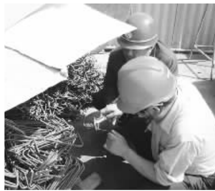
为保证工程施工质量,信阳华祥集团建筑分公司在航空 110 千伏变电站工程项目施工过程中,严把质量关。图为质检人员对箍筋和铆固长度进行检查。
