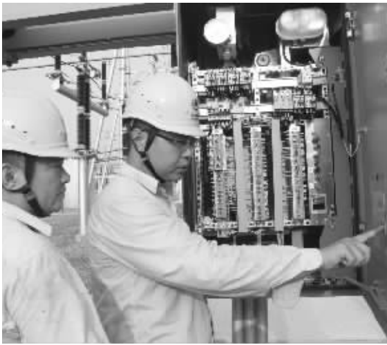
今年迎峰度夏期间,信阳电网供电形势异常严峻,部分变电站主变重载、过载现象严重,给电网运行带来严峻考验。信阳供电公司加强对变电站巡视、测温,及时消除隐患,确保变电站安全稳定运行。图为 8 月 31 日下午,220 千伏葵花变电站值班员巡视设备时的情景。 林平 许娟 摄
