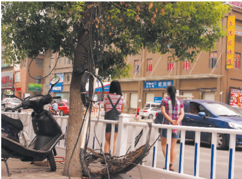
近日,记者接到市民打来的热线电话称,四一路沃尔玛超市对面一处电缆吊挂在树上并散落在路旁,甚至人行道的护栏也被缠绕在其中。希望有关部门尽快处理,也提醒路过的市民注意安全。 本报记者 张继疆 实习生 周静 摄
