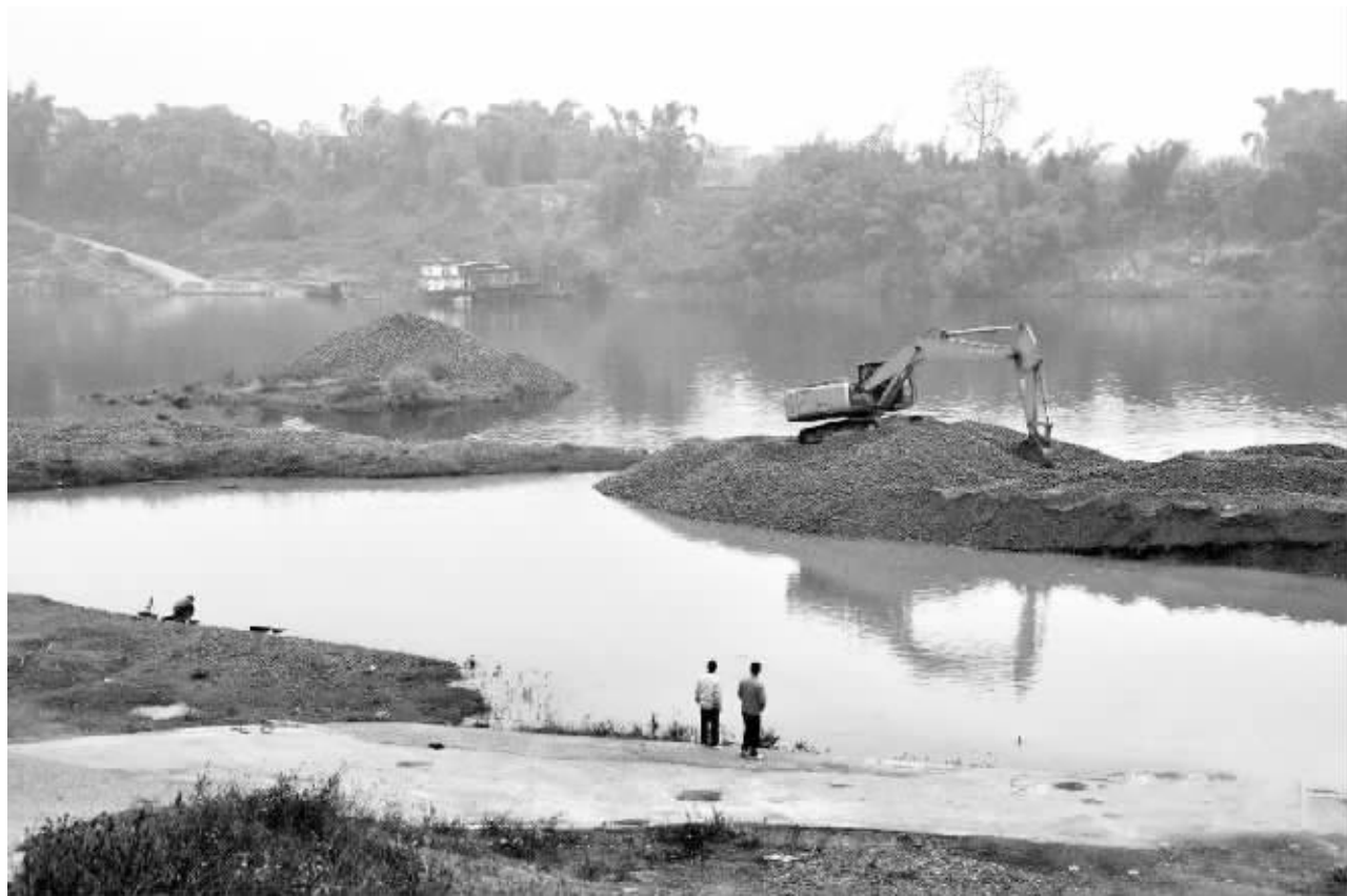
▲露天渣场无三防措施
