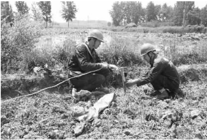
又到了插秧大忙季节,信阳供电员工深入田间,为农民朋友安装和检查临时用电,既保证抽水,又避免事故的发生。图为5月25日,董家河供电所的员工正在检查临时用电情况。 甘仁伟 摄
