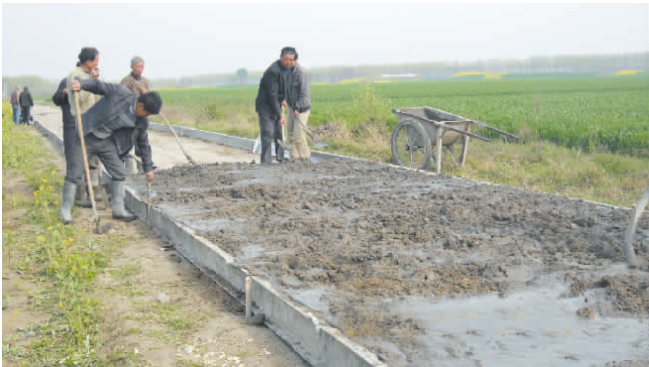
出行难困扰村民60多年,为修路,党员群众付出了艰辛的努力。日前,息县白土店乡桂庄村周堰组通往集镇的水泥路终于动工兴建。村民高兴地称这条路为“幸福路”。图为施工现场。
