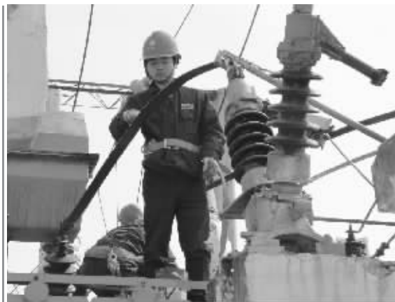
为了确保客车电气安全,武昌客车车辆段信阳运用车间组织技术组和相关班组对列车电力连接线、电气设备的绝缘进行了全面检查和检测,确保设备绝缘可靠,消除火灾隐患。图为该车间正在组织人员测量列车绝缘。方昉 摄
