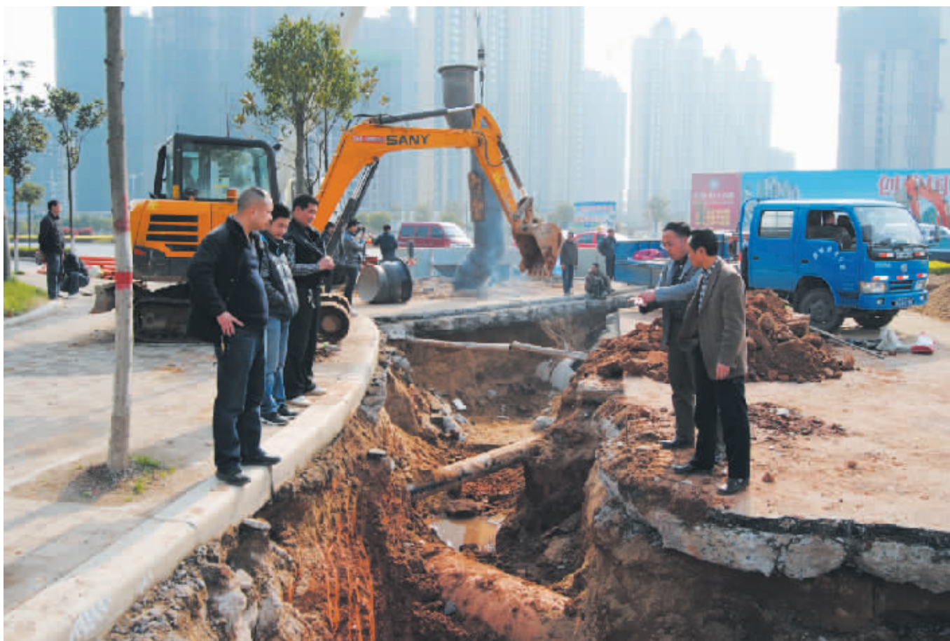
为提高羊山新区供水保障能力，连日来，市供水公司集中人力、物力，加班加点，在羊山新七大道与二十四大街交叉口进行过路管道的安装铺设。为尽量不影响交通，工程技术人员夜以继日施工，以最快的速度铺设过路管线，对接两端供水管网，争取在 4 月中旬全面完工。图为施工现场。 王昌红 摄
