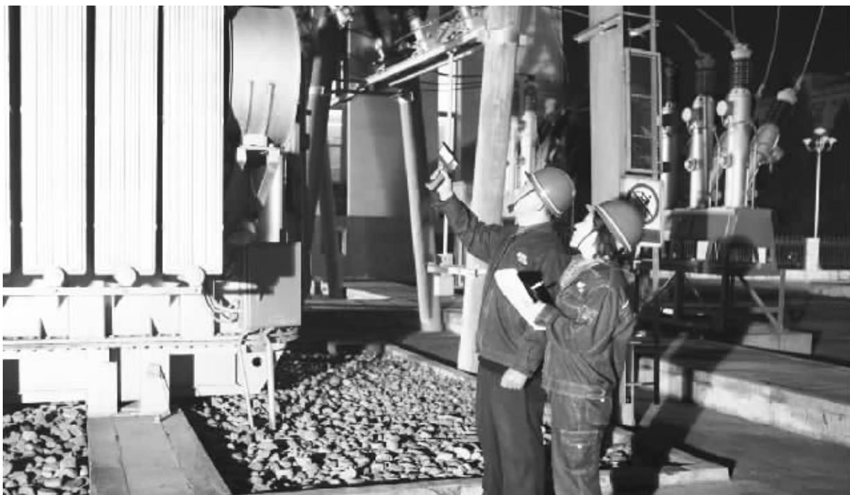
为了使辖区群众欢度元宵佳节,淮滨县电业局组织相关工作人员对所辖变电站进行24小时巡视,确保电网正常运行。图为2月24日,该局110千伏淮滨变电站值班人员正在对设备进行测温、巡视。
