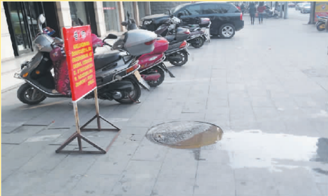
近日,位于中山南路和东方红大道交叉口南侧一家餐厅前的窞井一直从窞井盖往外流污水。据介绍,此种情况一个月前就开始了,请人疏通过好几次都没解决。从窞井盖流出的污水给过路行人带来了不便,本报希望相关部门尽快解决,还市民一个良好的出行环境。 见习记者 周亚涛 熊晓辉 摄
