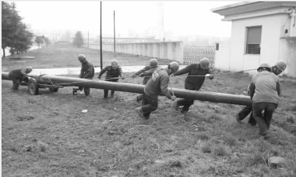
信阳没有集中供暖系统,冬季取暖负荷较大。信阳供电公司根据迎峰度冬负荷预测,全力开展配电网的消缺完善工作,让全市人民过一个温暖的冬天。图为11月30日,施工人员在羚锐大道运送电线杆时的情景。甘仁伟 摄
