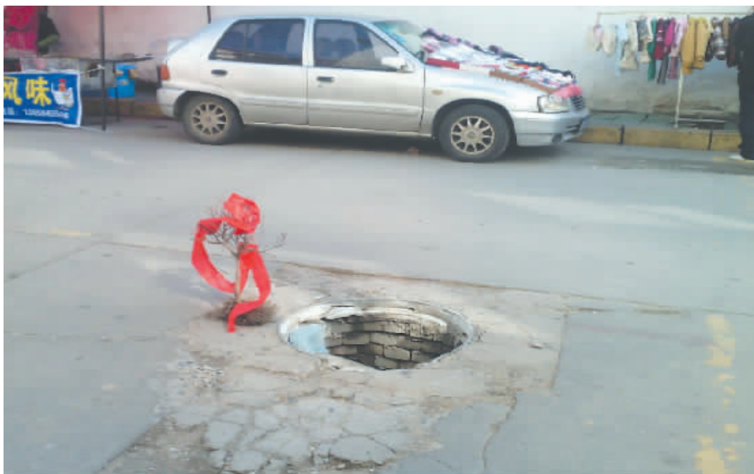
昨日,记者在我市统一街看到,路面中间一窨井盖损毁掉落在窨井中,来往行人及车辆纷纷躲避绕行,而热心的市民也在窨井旁放上了树枝,并缠上了红色布条作为“警示牌”提醒路人注意安全。本报呼吁有关部门能尽快更换井盖,排除安全隐患。
