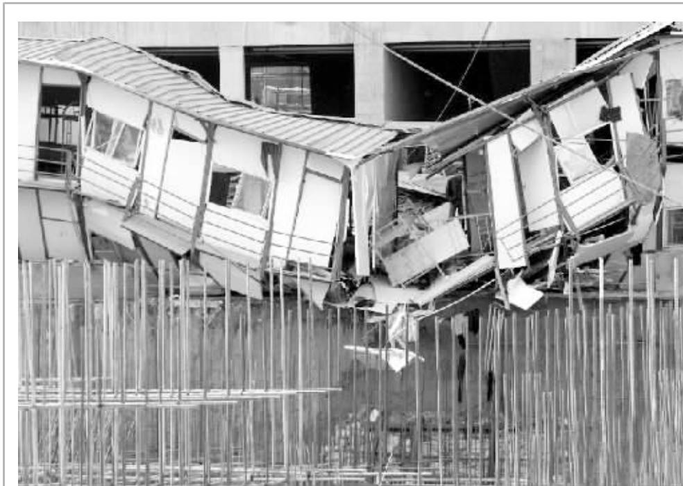
24日2时30分左右,郑州航空港区一辆水泥罐车意外侧翻,砸塌路边工棚,导致8人死亡、6人受伤,伤者已被紧急送往医院抢救。图为事故现场。 新华社记者 赵鹏 摄
