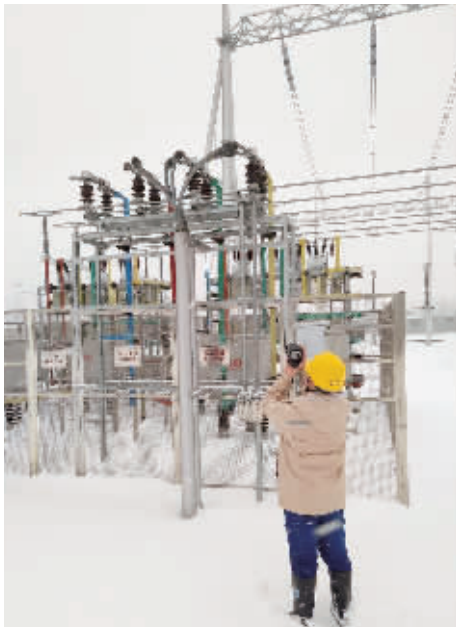
暴雪天气再度来袭,信阳供电公司积极应对,保障电力可靠供应。图为蒙城运维值班人员对该站设备开展特巡,清除覆冰。
